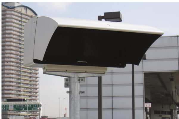
●ホーム監視モニター収容箱
