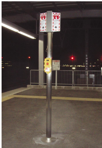
●非常通報押ボタン柱
